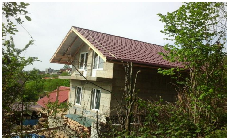
Фото 4. Строительство индивидуального жилого дома площадью 90 кв. м в СНТ Адлерского районе г. Сочи.
