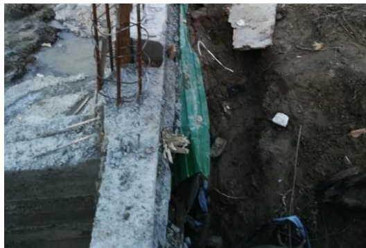
Фото 3. Подпорная стена из монолитного железобетона. Несоблюдение геометрии
